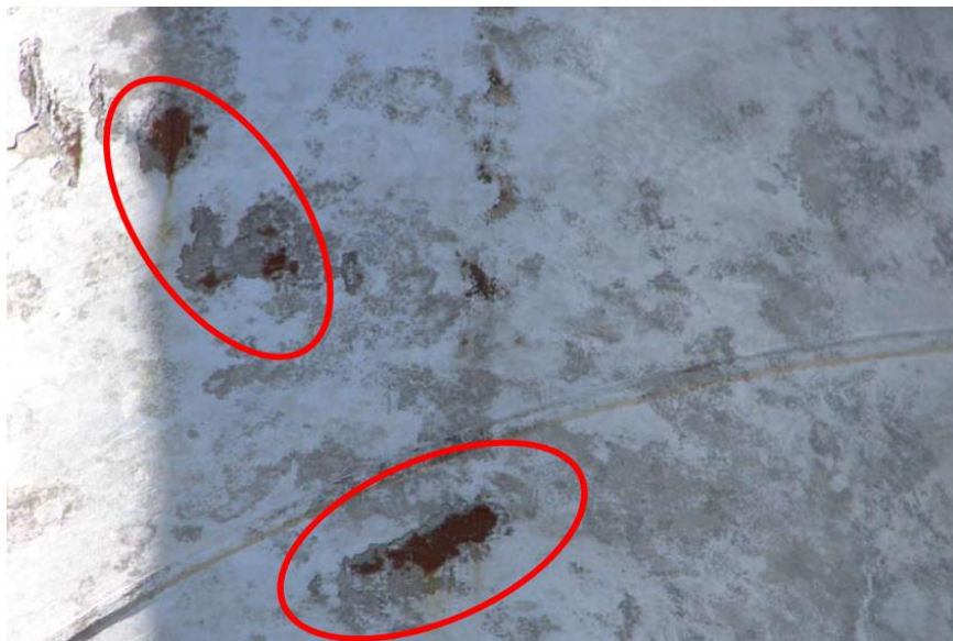
Rys. 2. Utlenienie warstwy wierzchniej materiału pod powłoką w wyniku zerwania warstwy cynkowej (miejsca oznaczone kolorem czerwonym).
