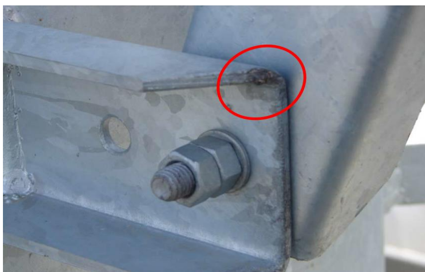
Rys. 3. Początek korozji w postaci utlenienia na krawędzi kształtownika (miejsce oznaczone kolorem czerwonym).
