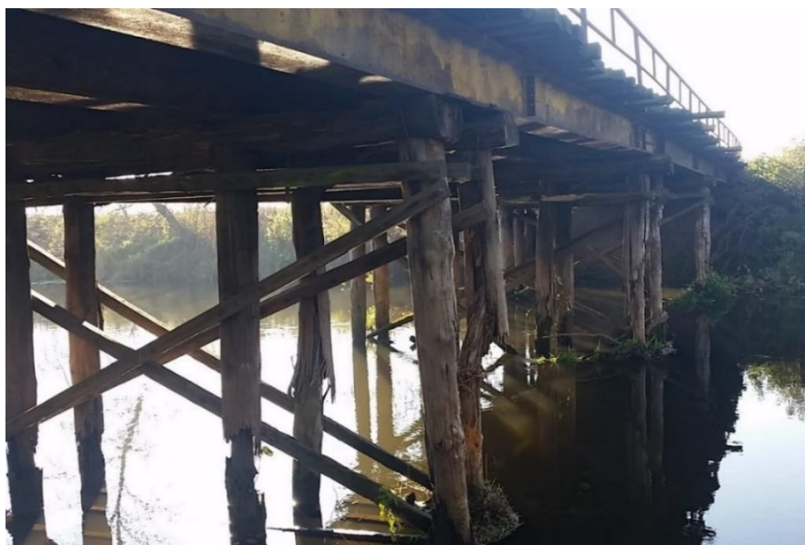
Rys. 4. Widok na uszkodzenia podpór pośrednich (opracowanie własne).
