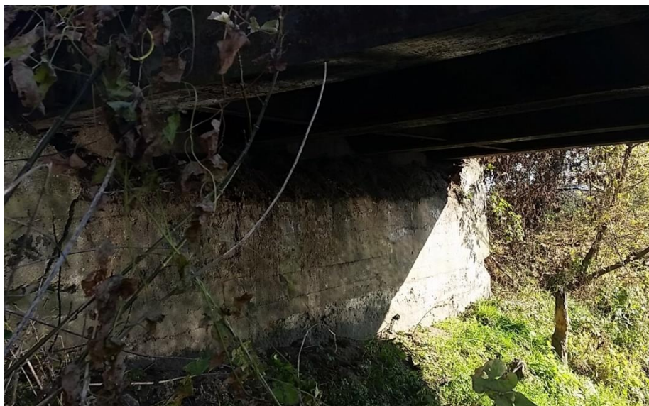
Rys. 3. Widok na uszkodzenia ściany żelbetowej przyczółku (opracowanie własne).
