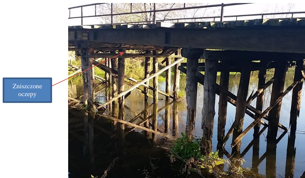
Rys. 5. Widok na uszkodzenia stężeń podpór pośrednich (opracowanie własne).
