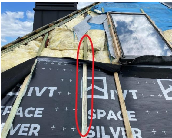
Rys. 3c. Kontrłaty (kontrłata obwiedziona kolorem czerwonym) i folia wiatroizolacyjna koloru czarnego, pod kontrłatami [7].
