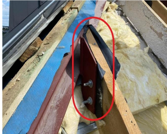
Rys. 3f. Węzeł konstrukcyjny elementów drewnianego i stalowego (obwiedziony kolorem czerwonym) więźby dachowej. Widoczna tłumiąca folia pomiędzy drewnem a stalą w tym węźle [7].
