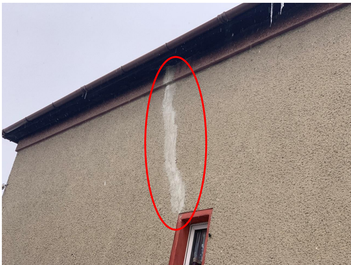
Fot. 2. Widoczne naprawiane pęknięcie tynku elewacyjnego rozpoczynające się od górnego naroża otworu okiennego.
