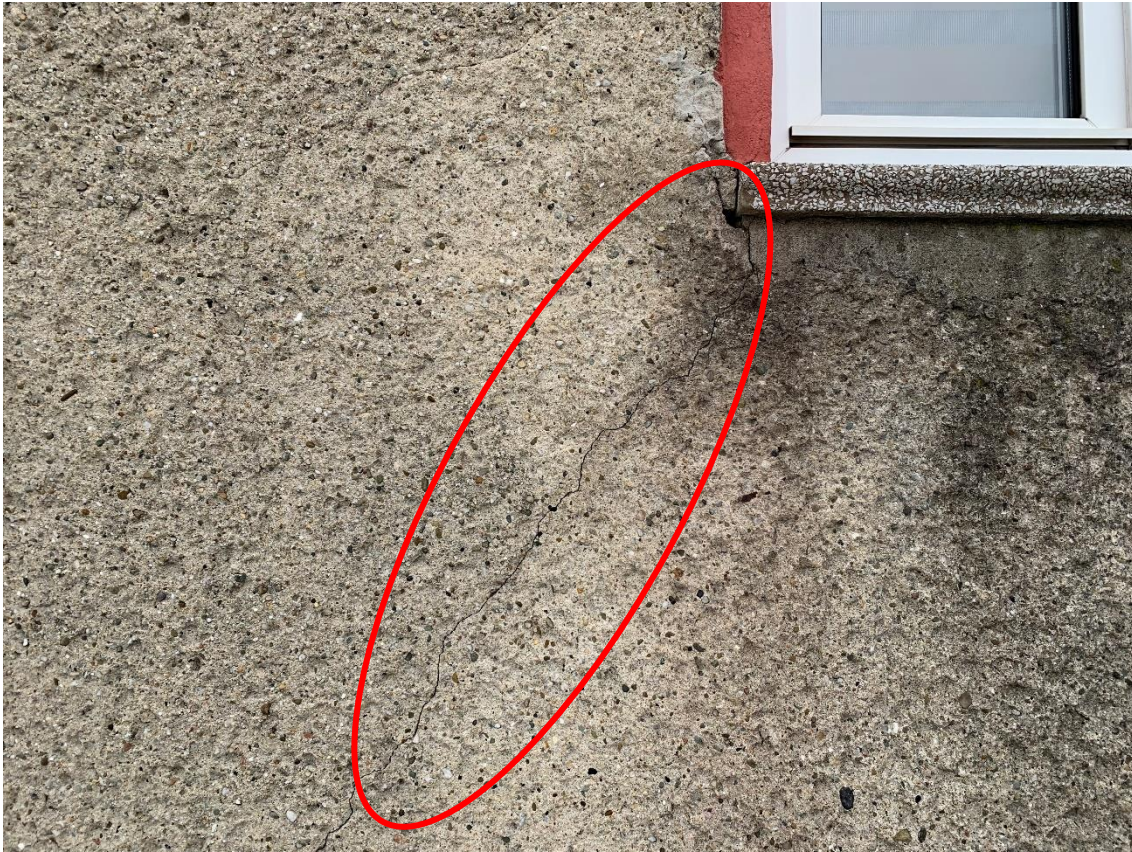
Fot. 5. Widoczne ukośne pęknięcie tynku elewacyjnego w okolicach osłabienia ściany otworami okiennymi.
