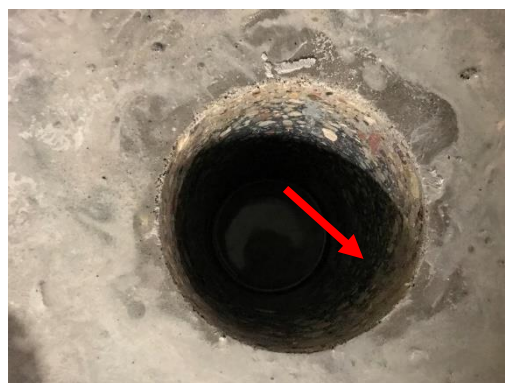
Rys. 2.6. Strzałką koloru czerwonego oznaczono wodę znajdującą się pomiędzy warstwą posadzki a płytą fundamentową.
