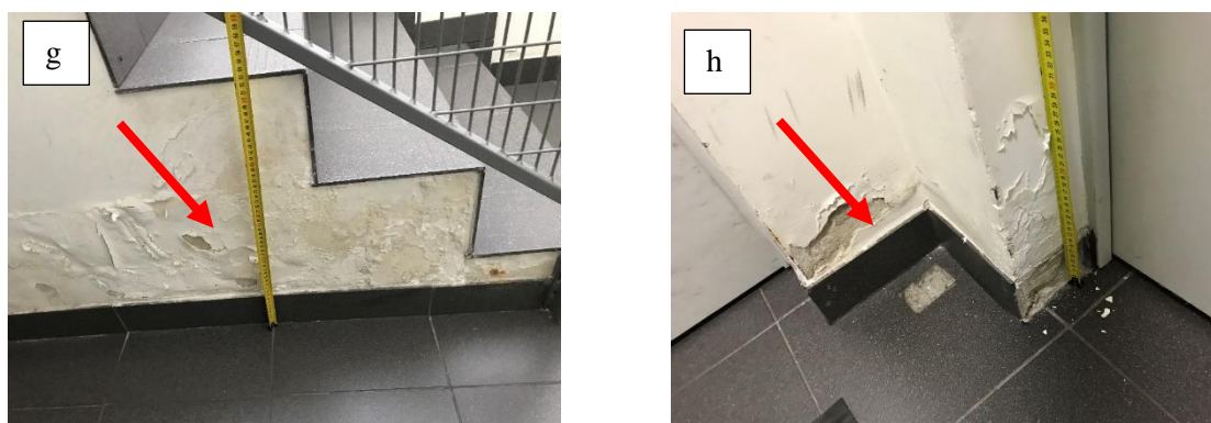
Rys. 1. Zawilgocenia części podziemnej budynku: a), b), c) ściany pomieszczeń technicznych komórek lokatorskich; d), e) ściany zewnętrzne garażu podziemnego; f), g), h) ściany klatek schodowych.
