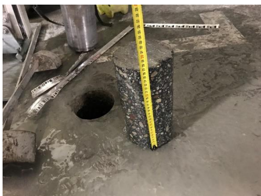
Rys. 2.5. Pomiar grubości odwiertu wykonanego w płycie fundamentowej garażu podziemnego – wynik pomiaru 27,7 cm.
