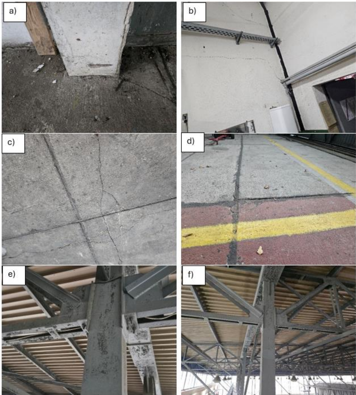
Rys. 2. Stan obiektu, a) uszkodzenia słupa konstrukcji nośnej, b) spękania ścian, c, d) stan posadzki w hangarze, e, f) stan stalowej konstrukcji dachu.
